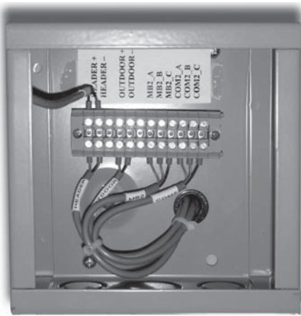
FIGURE 15. CÂBLAGE DES COMMANDES DE BASSE TENSION
